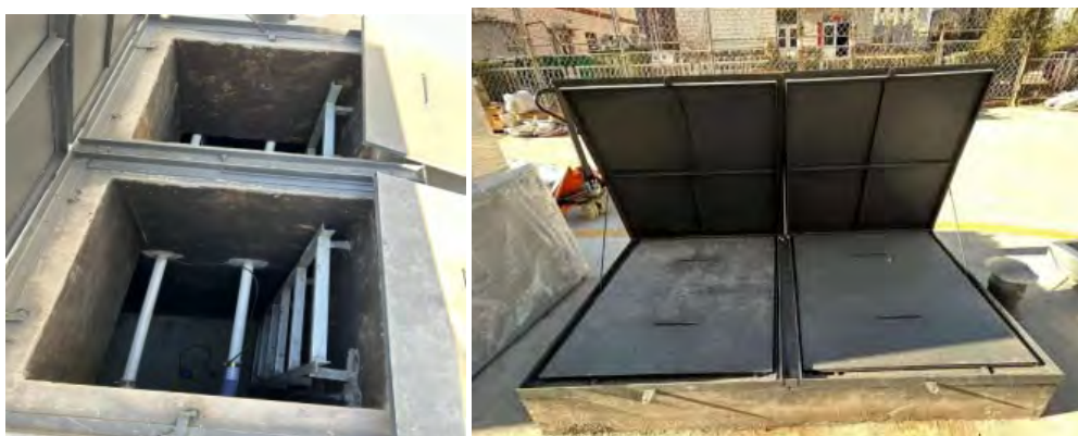
图10-5 放射性衰变池实物照片
